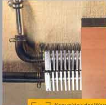
Konvektor der Warmwasserzentralheizung.
