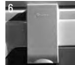
6 Orifice d'aération pour chauffe-eau
