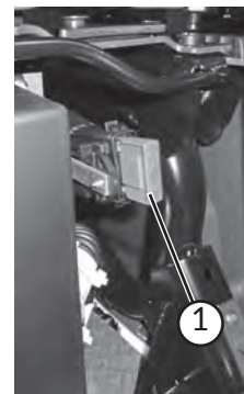
Fusible principal batterie de cellule
