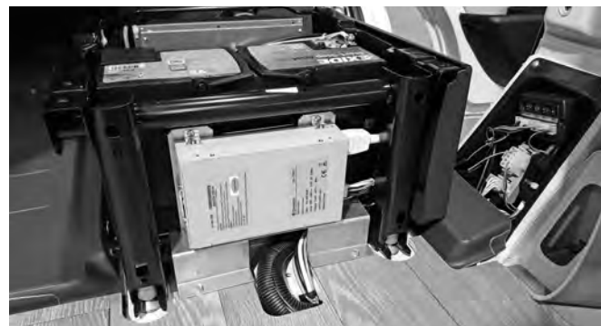
Électrique du véhicule sous le siège passager
