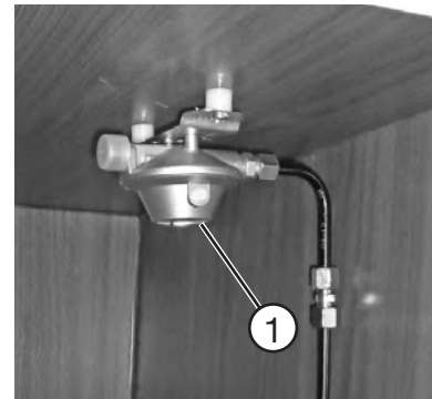
Régulateur de gaz monté sur plafond
