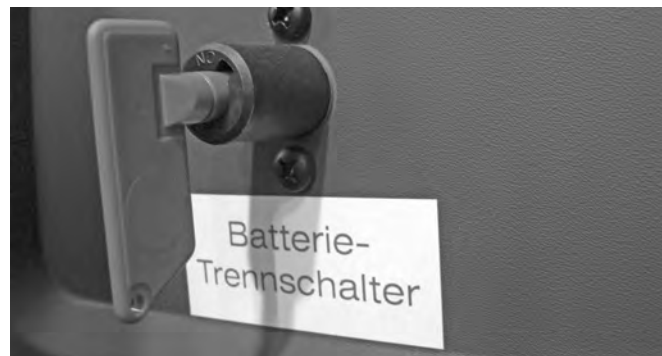
Interrupteur principal de batterie
