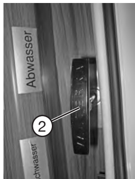
Clapet pour l'écoulement des eaux usées
