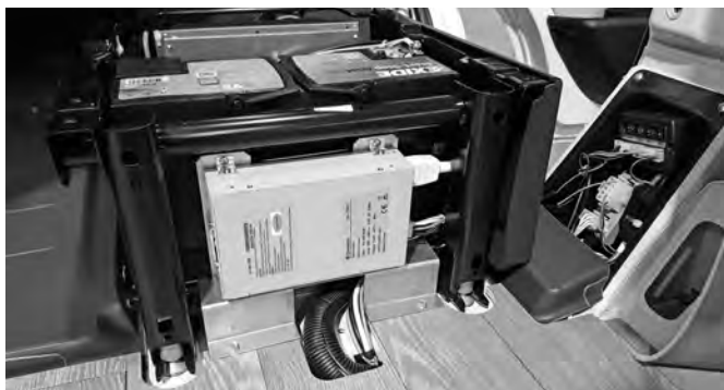
Électrique du véhicule sous le siège passager
