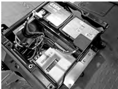
Électrique du véhicule sous le siège passager
