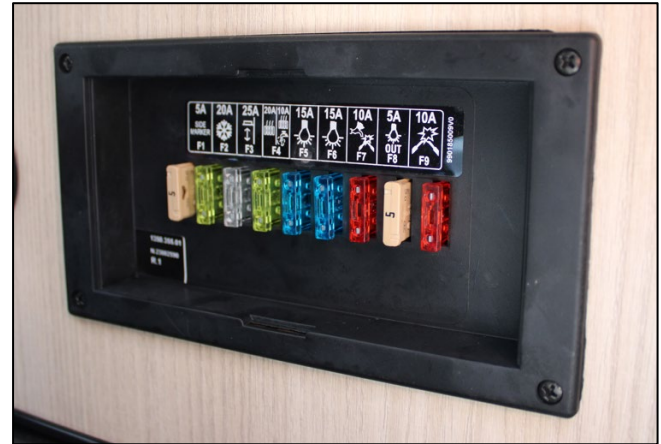
12 V-Sicherungskasten unter dem Fahrersitz (Abb. beispielhaft)
