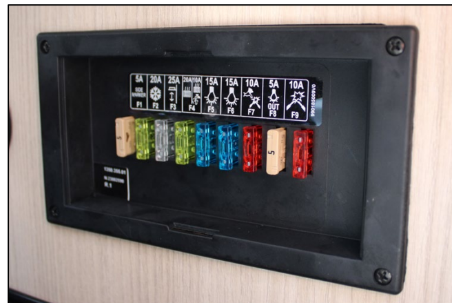
Boîte à fusibles 12 V sous le siège conducteur (exemple)
