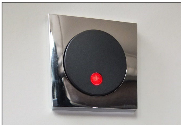
Schalter Abwassertank Beheizung am Sitzkasten
