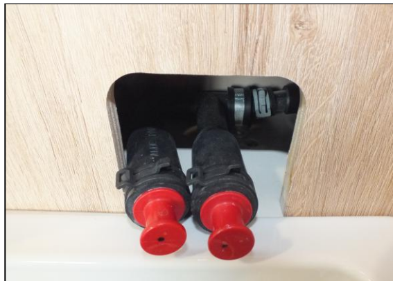
Orifices pour le nouveau remplissage du chauffage (exemple)
