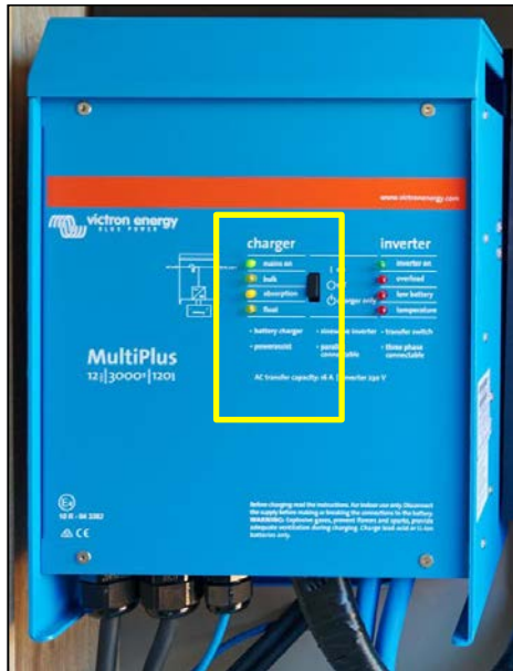
Batterieladegerät in der Heckgarage (Abb. beispielhaft)
