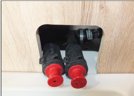
Öffnungen zum Neu-Befüllen der Heizung (Abb. beispielhaft)
