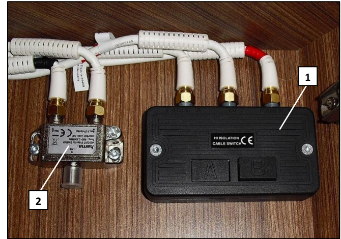
Kanalschalter „A/B“ und Signalverteiler (beispielhaft)
