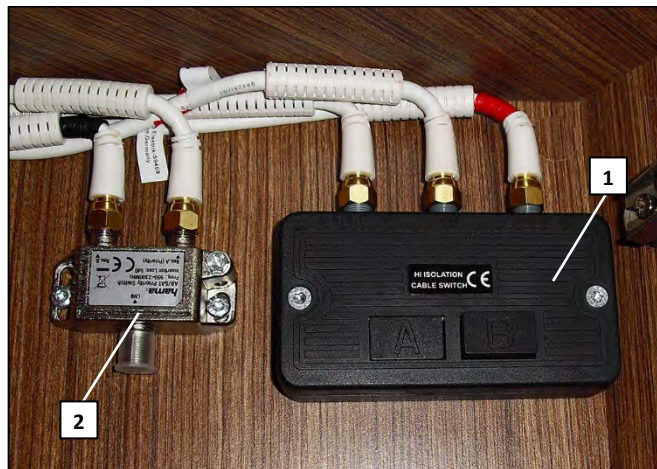
Kanalschalter "A/B" und Signalverteiler (beispielhaft)
