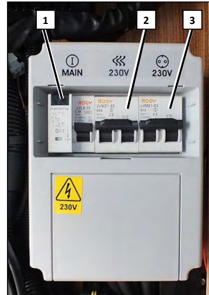
230 V-Absicherung mit FI-Schutzschalter (Abb. beispielhaft)
