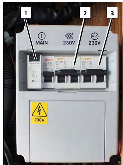
Coupe-circuit 230 V avec disjoncteur différentiel (exemple)
