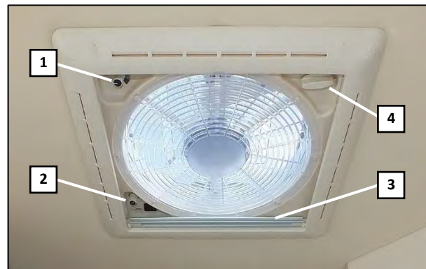
Ventilateur de toit avec store occultant
