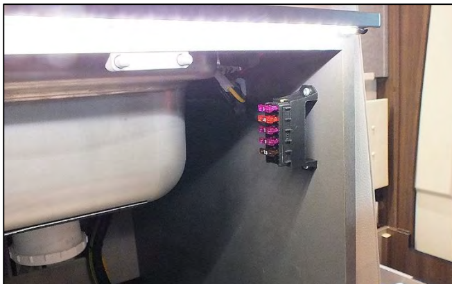
Porte-fusible supplémentaire sous l'évier (exemple)
