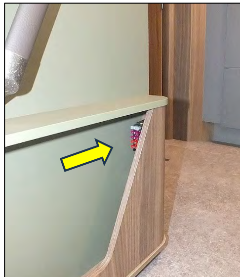
Porte-fusible supplémentaire dans la zone d'entrée (exemple)
