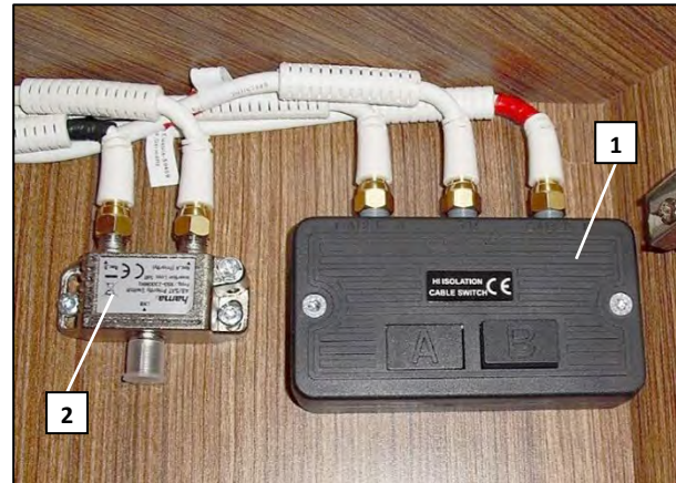
Kanalumschalter "A/B" und Signalverteiler (beispielhaft)
