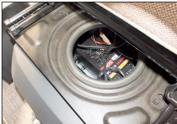
Chargeur de batterie sous le siège conducteur
