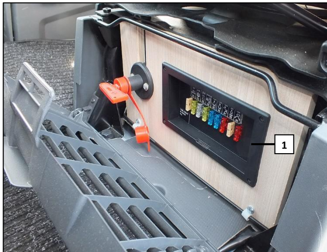
12 V-Sicherungskasten und Batterietrennschalter unter dem Fahrersitz (Abb. beispielhaft)
