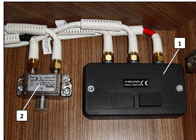
Kanalschalter „A/B“ und Signalverteiler (beispielhaft)
