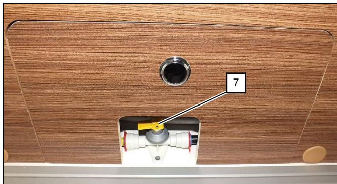
Gelbes Ablass-Ventil der Alde-Warmwasser-Heizung
