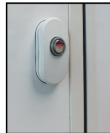
Trappe de service verrouillée mais pas fermée à clé (le cylindre est sorti)
