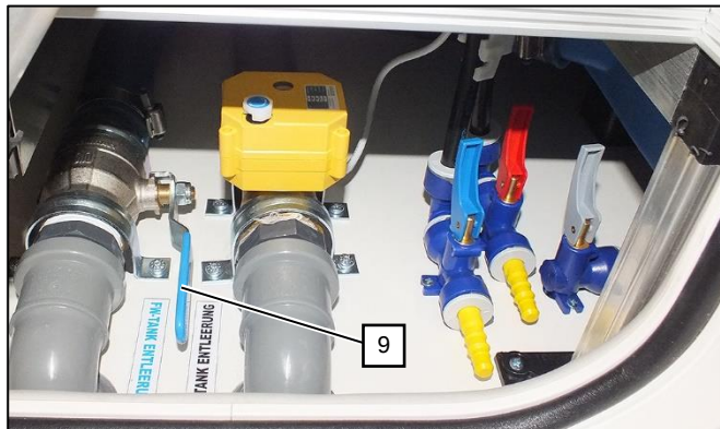
Frishwassertank Entleerung (blauer Hebel)
