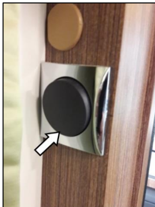
Interrupteur dans l'espace de vie (exemple)
