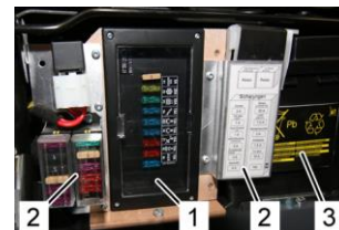
Boîtier à fusibles 12V
