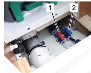
Robinet de vidange de la tuyauterie
