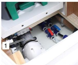
Wasserpumpe mit Ablasshähne
