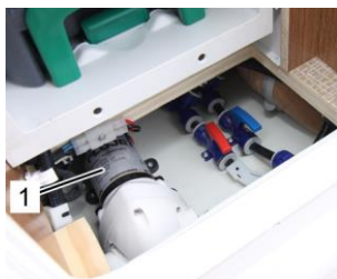
Pompa dell'acqua con rubinetti di scarico
