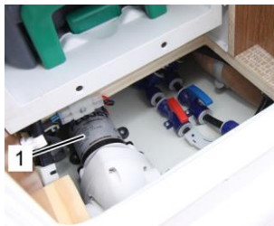
Pompe à eau avec robinets de vidange
