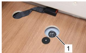
Rubinetto di scarico serbatoio dell'acqua sanitaria
