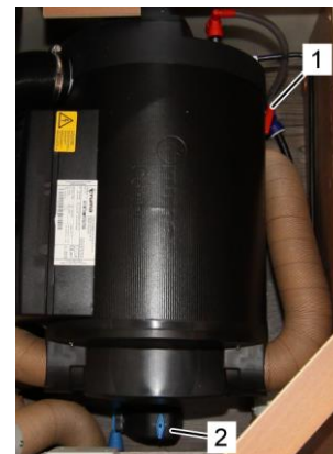
Impianto di riscaldamento
