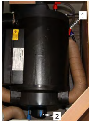
Impianto di riscaldamento
