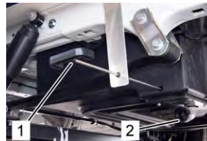
Serbatoio acque grigie
