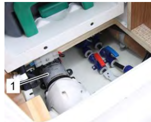
Robinet de vidange de la tuyauterie
