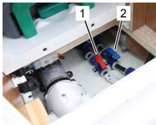
Robinet de vidange de la tuyauterie
