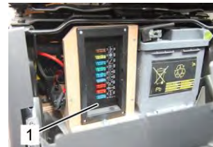
Boîtier à fusibles 12 V
