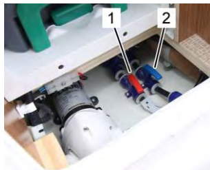
Rubinetti di scarico sistema di tubature
