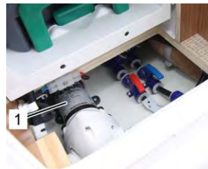
Rubinetti di scarico sistema di tubature
