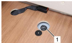
Rubinetto di scarico serbatoio dell'acqua sanitaria
