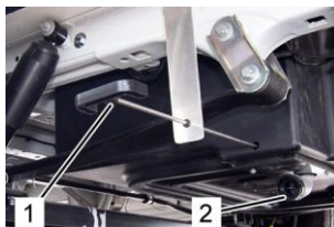
Réservoir d'eaux usées
