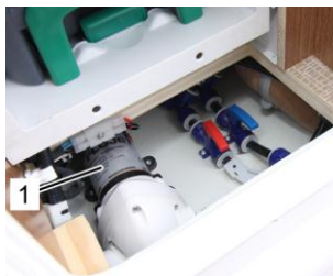
Robinet de vidange de la tuyauterie
