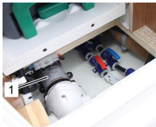
Rubinetti di scarico sistema di tubature
