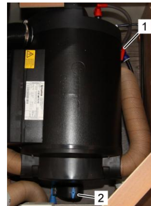
Impianto di riscaldamento
