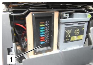
Boîtier à fusibles 12 V
