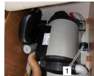
Ouvrir la vanne FrostControl
