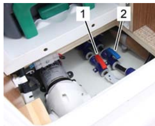
Rubinetti di scarico sistema di tubature
