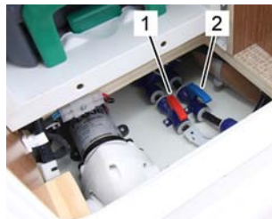
Robinet de vidange de la tuyauterie
