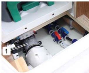
Robinet de vidange de la tuyauterie
