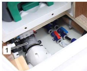
Rubinetti di scarico sistema di tubature
