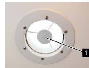
Évacuation d'air de la cabine de douche
