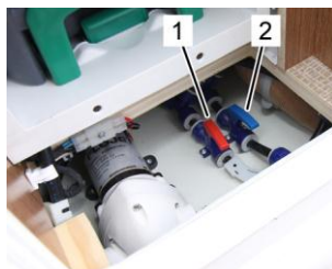
Rubinetti di scarico sistema di tubature
