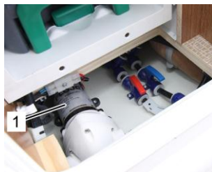
Rubinetti di scarico sistema di tubature
