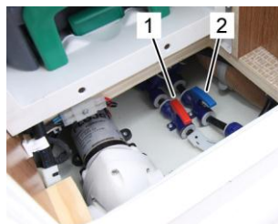
Robinet de vidange de la tuyauterie
