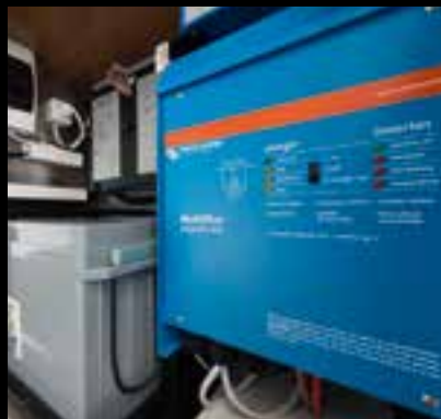
Centrale de distribution électrique (4)
