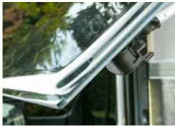
Baies SEITZ double vitrage, avec moustiquaire et store occultant.
