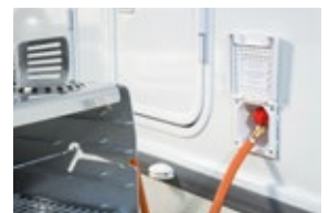
Prise gaz extérieur
