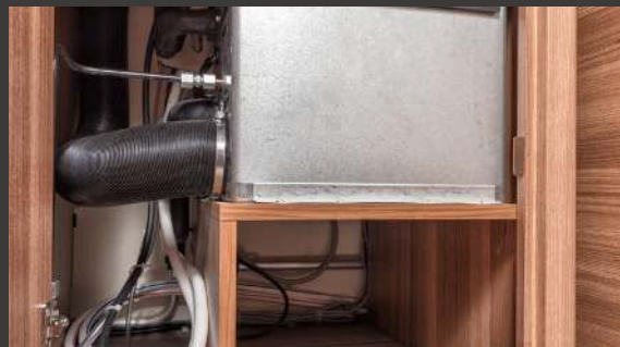
Riscaldamento Alde per l'acqua dei sanitari . / Calefacción Alde . / Chauffage à eau chaude Alde .
