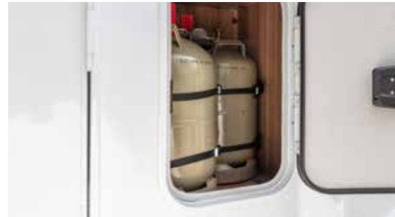
Gavone per le bombole del gas (spazio per 2 bombole da 11 kg). Cofre para 2 bombonas de gas de 11 k. Coffre à gaz pour 2 bouteilles de gaz de 11 kg.
