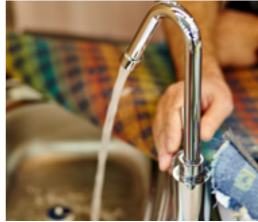
Installation conforme des circuits d'eau
