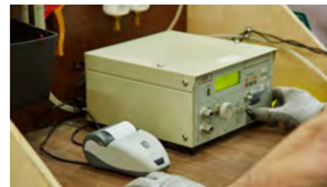
Test des systèmes de gaz par du personnel certifié selon le protocole allemand DVGW.
