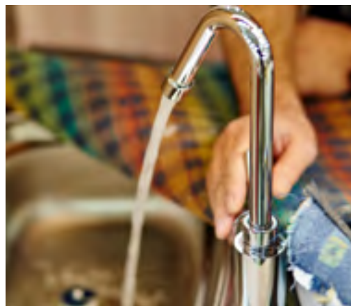
Installation conforme des circuits d'eau
