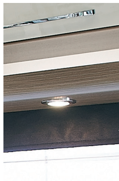
Nouvel éclairage New lighting
