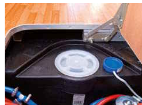
Réservoir eaux usées
