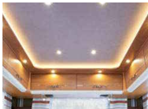
Éclairage indirect avec profil en bois
