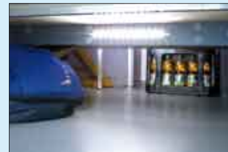
illuminazione supplementare doppio pavimento
