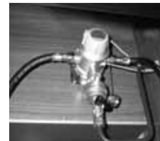
Installation de gaz Duo Control , changement automatique de la bouteille de gaz vide à la bouteille pleine, avec protection anti-gel
