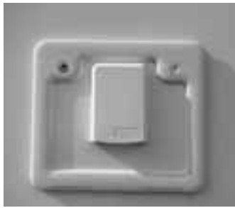
Toilettes : extracteur d'air automatique
