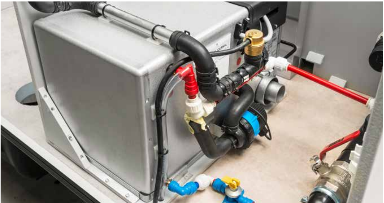
CHAUFFAGE CENTRAL GAZ ET EAU CHAUDE ALDE
