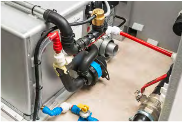
CHAUFFAGE CENTRAL GAZ ET EAU CHAUDE ALDE
