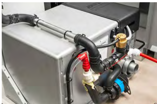
CHAUFFAGE CENTRAL GAZ ET EAU CHAUDE ALDE
