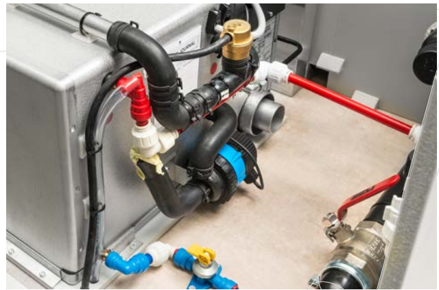
CHAUFFAGE CENTRAL GAZ ET EAU CHAUDE ALDE
