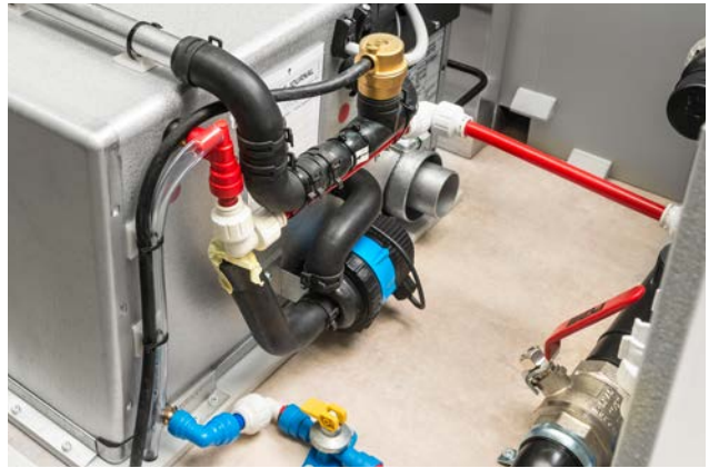
CHAUFFAGE CENTRAL GAZ ET EAU CHAUDE ALDE
