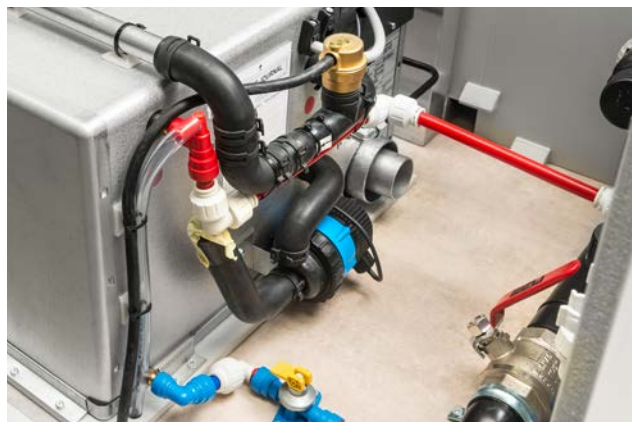
CHAUFFAGE CENTRAL GAZ ET EAU CHAUDE ALDE
