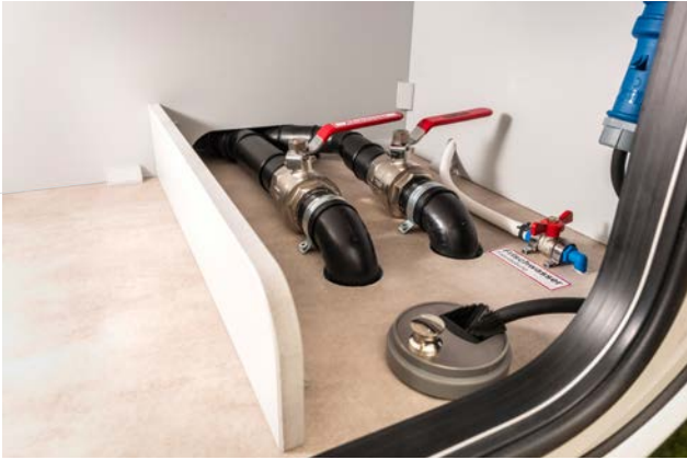
VANNES D'AMENÉE ET D'ÉVACUATION D'EAU
