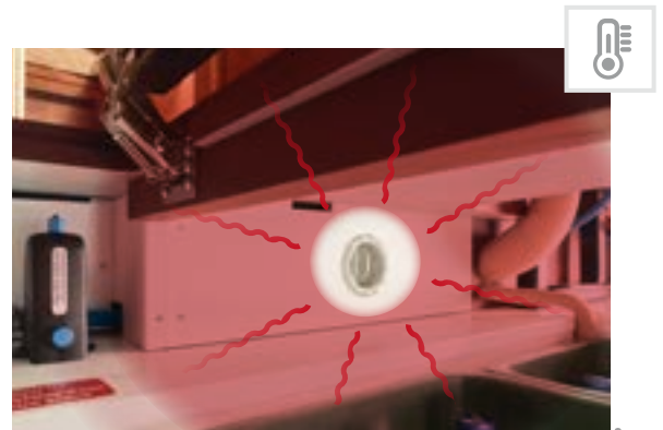
Chauffage par système de récupération de la chaleur Truma Combi 6 avec de nombreuses bouches d'air chaud dans l'ensemble de la soute profondément décaissée dans le double plancher, au niveau de l'habitacle, dans le garage à scooter, en cabine et au niveau des portières sensibles au froid
