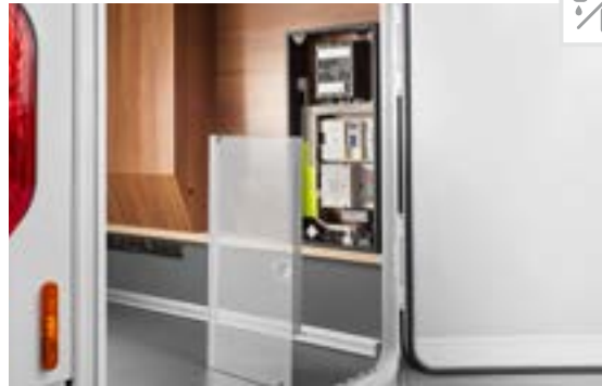
Centrale électrique bien accessible dans le garage à scooter
