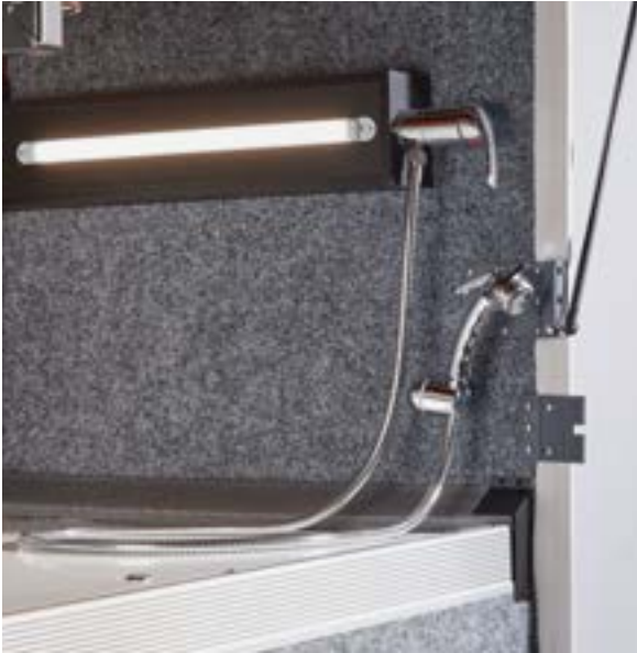
avec eau froide et eau chaude dans le garage à scooter
