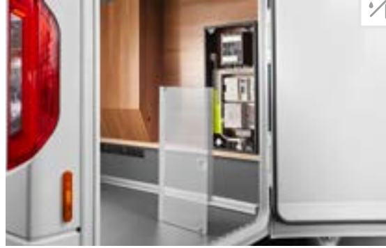
Centrale électrique facilement accessible dans le garage à scooter
