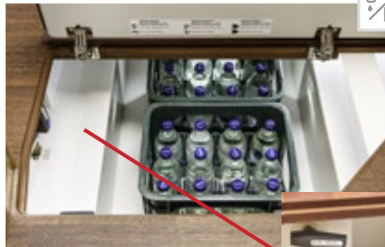
Centrale de vidange d'eau dans la soute profondément décaissée dans le double plancher ; peut également être commandée par la porte de cellule
