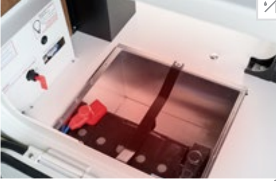
Centrale à batteries chauffée et l'interrupteur principal des batteries. De série : batteries gel 2 x 80 Ah, bien accessibles, batterie lithium-ion en option, 90 Ah avec contrôleur de batteries
