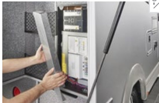
Centrale électrique facilement accessible dans le garage
