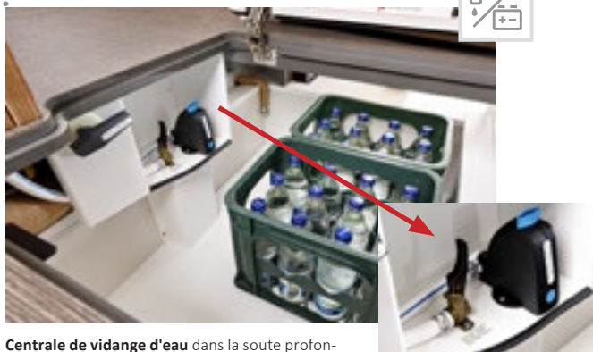
Centrale de vidange d'eau dans la soute profondément décaissée dans le double plancher ; peut également être commandée par la porte de cellule
