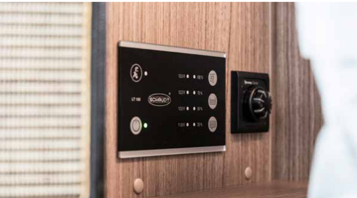
Bedienzentrale und Hauptpanel
