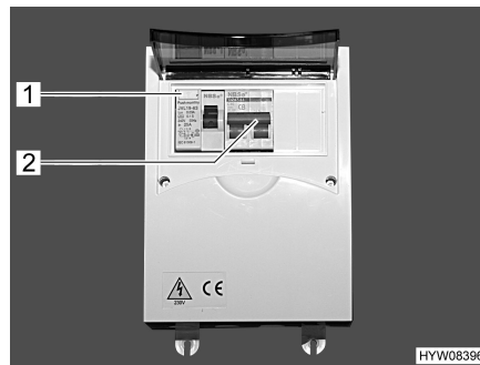
Fig. 61 Coffret de fusibles 230 V avec disjoncteur de protection de circuit et disjoncteur FI
