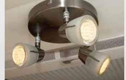
Éclairage à leds basse consommation
